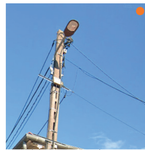
Candélabre sur poteaux béton
